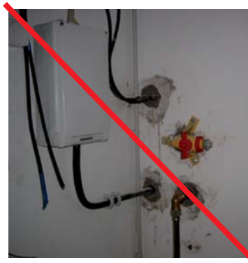
Unzureichende Hauseinführung in unterkellerten Gebäuden (keine korrekten Einführungen genutzt) (Quelle: Fachverband Hauseinführungen für Rohre und Kabel e.V.)
