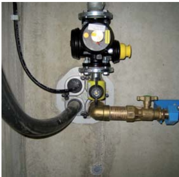
Korrekte Hauseinführung in unterkellerten Gebäuden (Quelle: Fachverband Hauseinführungen für Rohre und Kabel e.V.)
