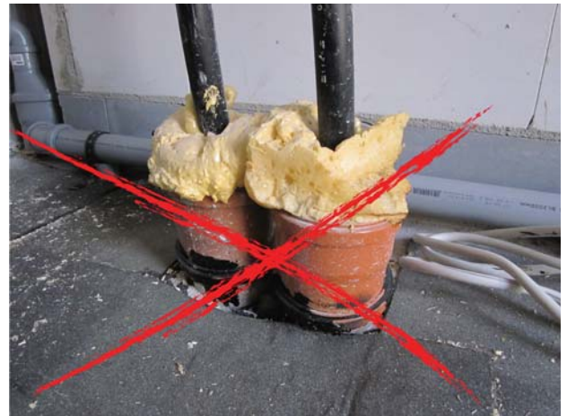
Nicht zulässige Hauseinführung mit KG Rohren und Bauschaum als Dichtmaterial (Quelle: Fachverband Hauseinführungen für Rohre und Kabel e.V.)
